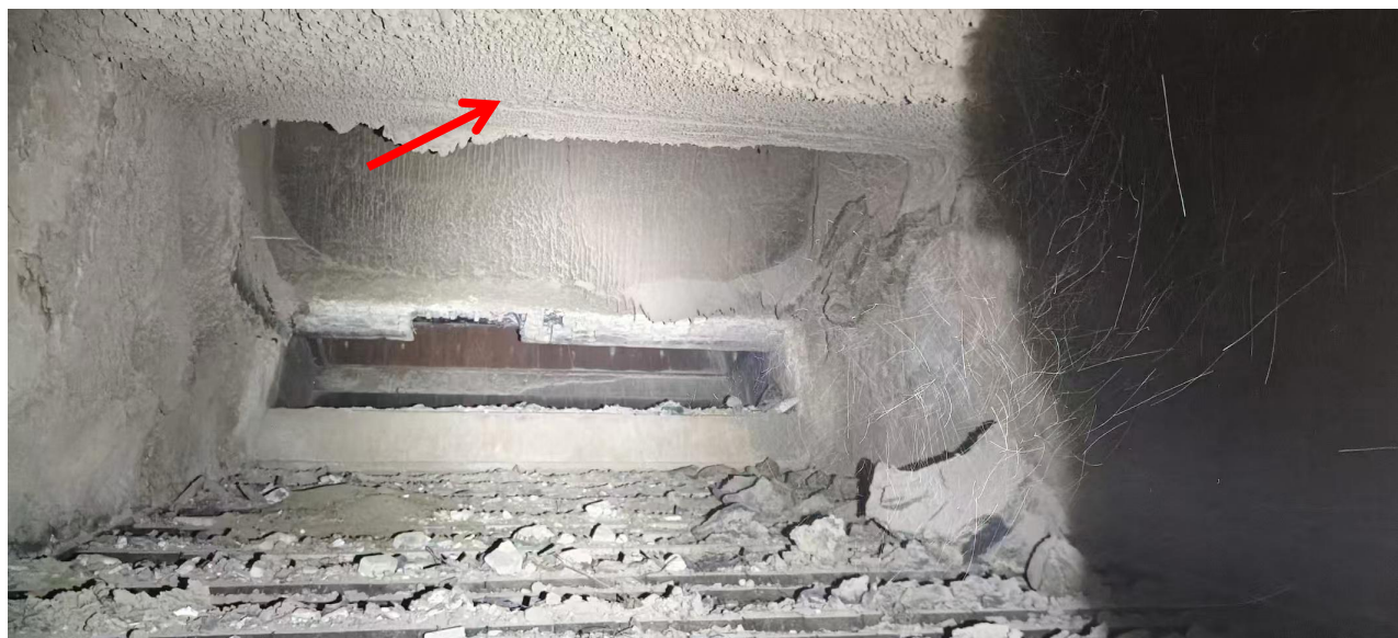
2#炉停炉后全貌。 后拱覆盖焦层2-3cm。
