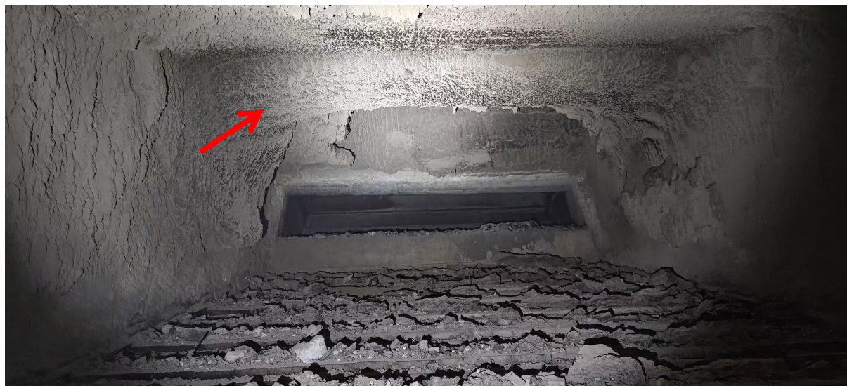
1#炉停炉后全貌。 后拱覆盖焦层20-30cm。
